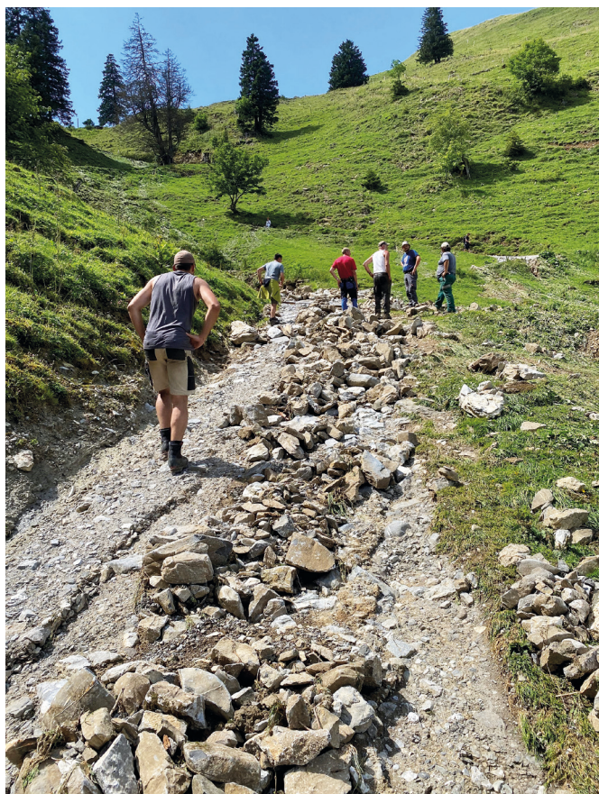
Unwetterschäden Alperschliessung Fronalp
