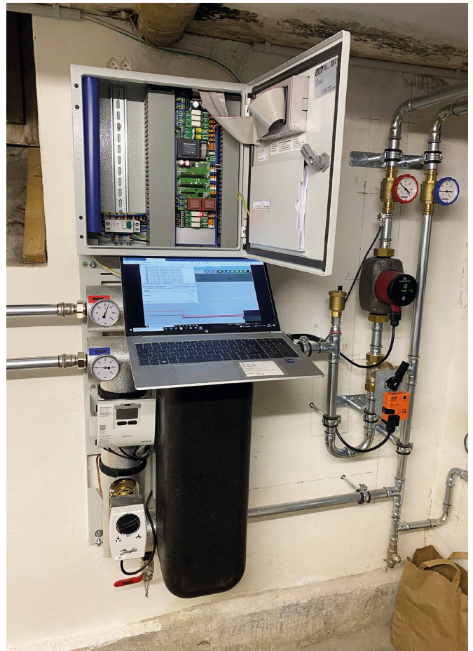
Inbetriebnahme neue Wärmeübergabestation
